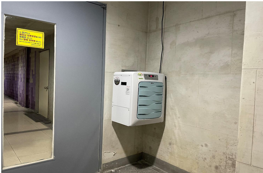
제습기 설치 완료
