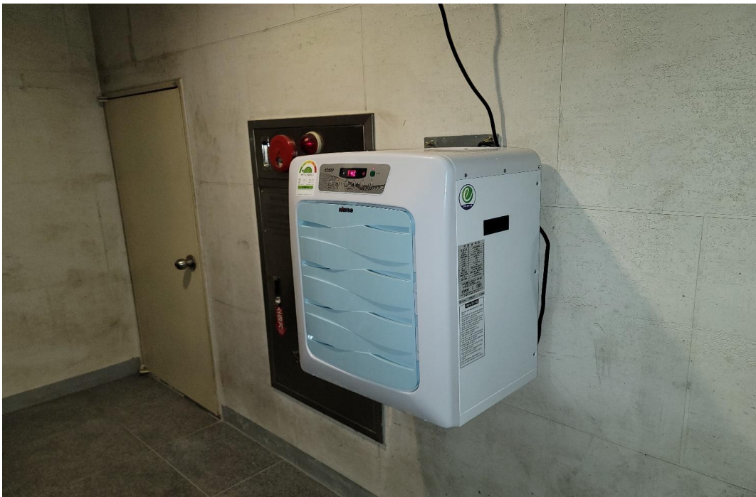
제습기 설치 완료
