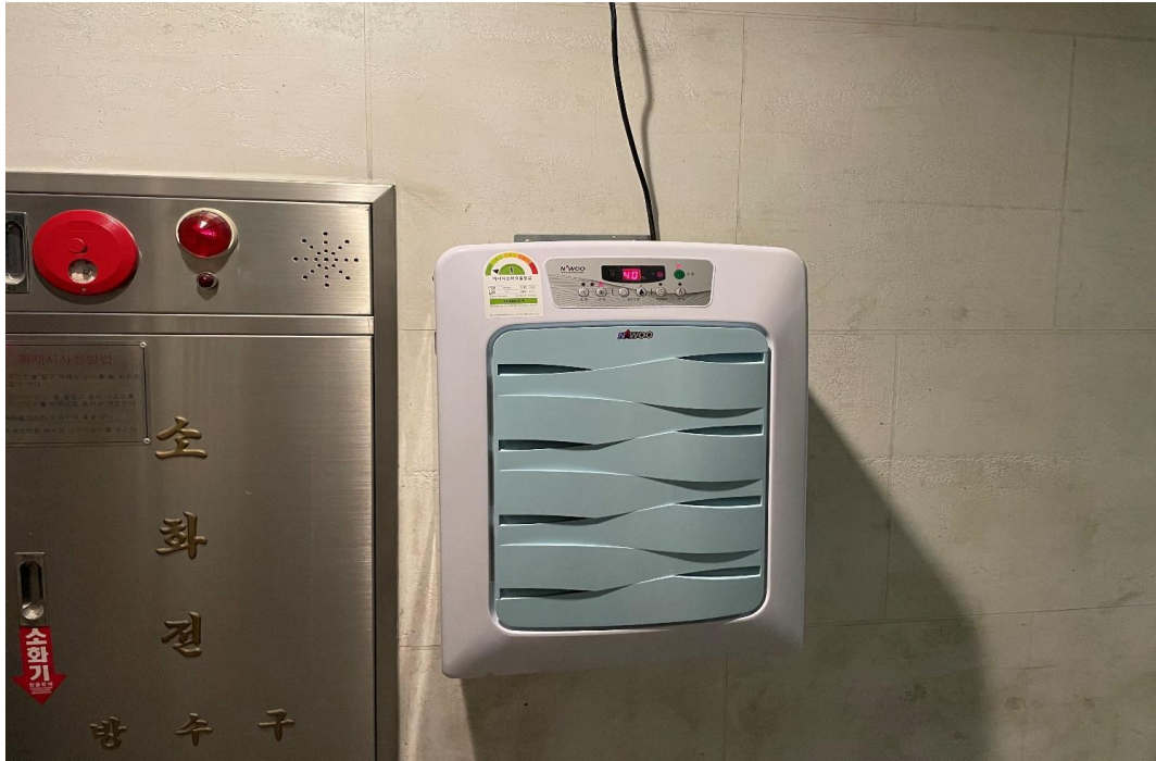
제습기 설치 완료
