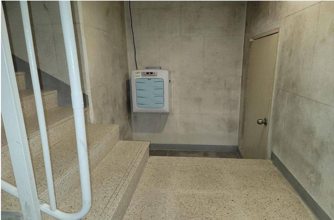
제습기 설치 완료
