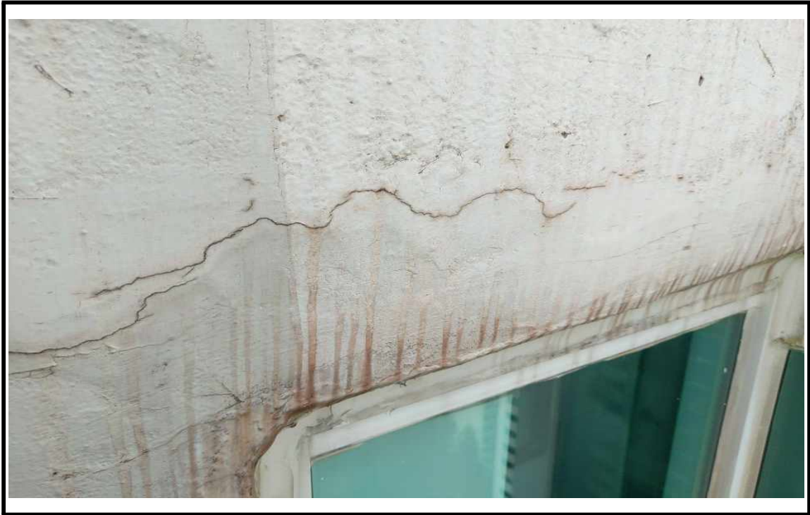
◎ 옥상 파라펫 균열(시공 전)
