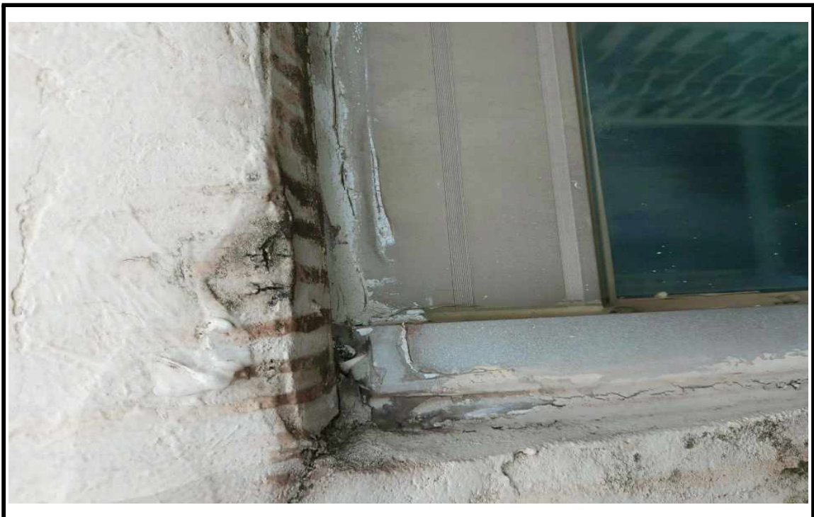
◎ 세대 창틀주의 균열(시공 전)
